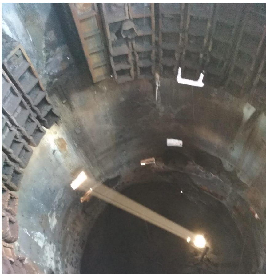
Рисунок 5.2 – Фактичний стан внутрішніх поверхонь охолоджувальної і неохолоджуваної зон шахти печі ДП-3
