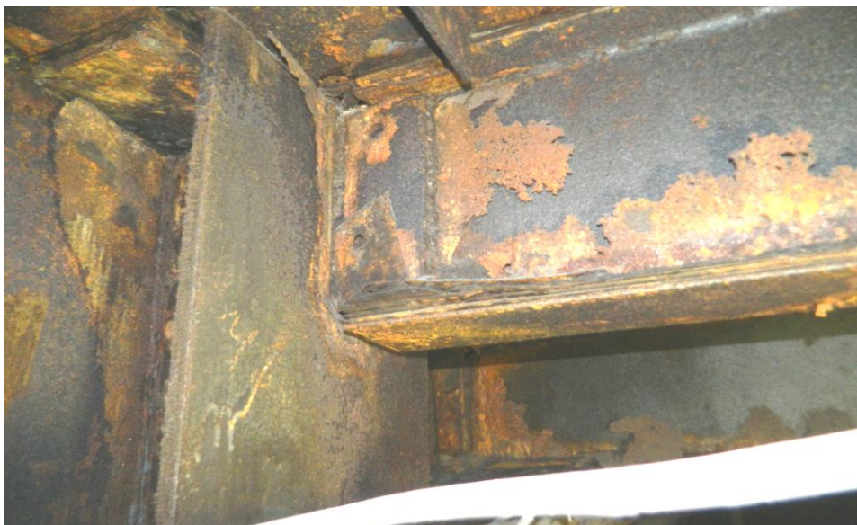
Рисунок 2.4 – Результат корозійного зносу металоконструкції МБЛЗ (несучі перекриття криволінійної ділянки)
